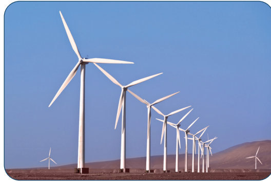
شكل 7-19 توليد الكهرباء باستخدام طاقة الرياح
